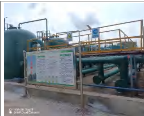
采出水站过滤罐区
