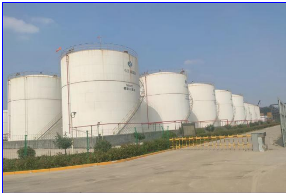
现有工程罐区
