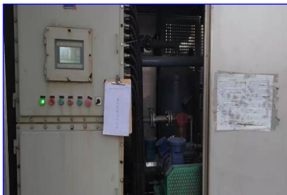
油气回收装置
